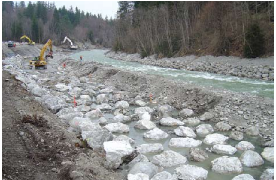
Bild 15. Umleitung Kander über bereits fertig gestellten Teil der Blockrampe und Bau der zweiten Hälfte.
