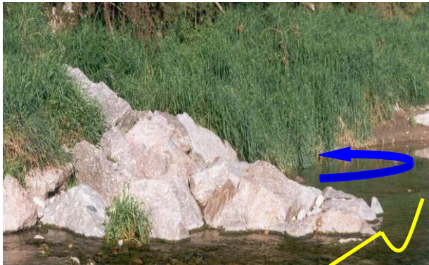
Kolkbildung hinter Buhnen Wigger, Gemeinden Langnau und Reiden vif Januar 2002
