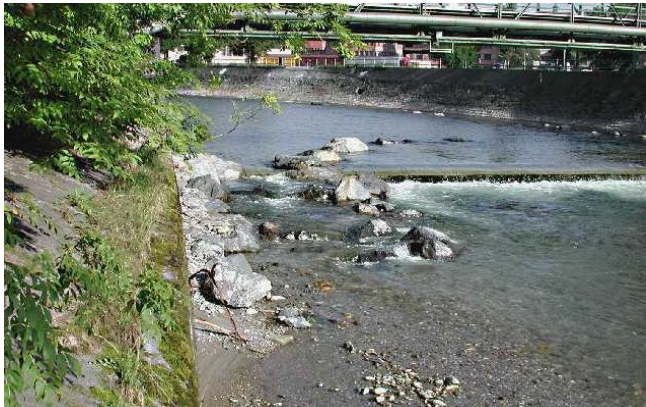
Im Flusslauf seitlich angelegter Fischaufstieg mit Beckenstruktur Kleine Emme, Gemeinde Emmen vif Mai 2002
