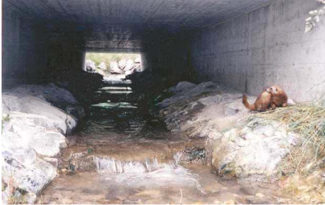
Seitliche Bermen in SBB-Durchlass für Kleintierwechsel Morgenrotbach, Gemeinde Root vif September 1995
