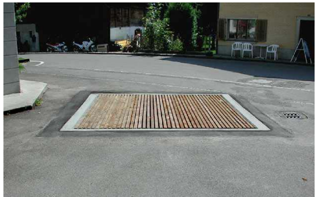
Lichtfenster fördern den Fischaufstieg in eingedeckten Bach- abschnitten Dorfbach, Gemeinde Geuensee vif August 2001
