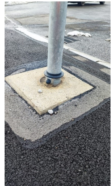
Falsche Montage überstehend
