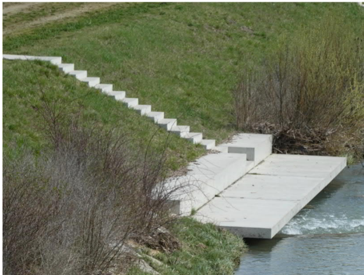
Zugang zum Gewässer
