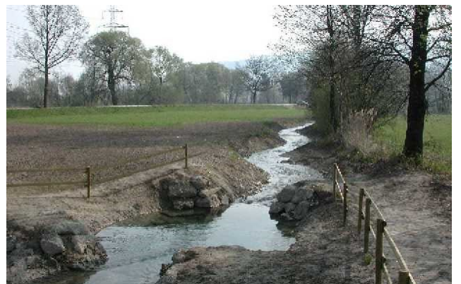
Revitalisierter Bachlauf kurz nach dem Abschluss der Arbeiten, (Giesse: mit Grundwasser gespiesenes Gewässer) Fördlibach, Gemeinde Root vif April 2002
