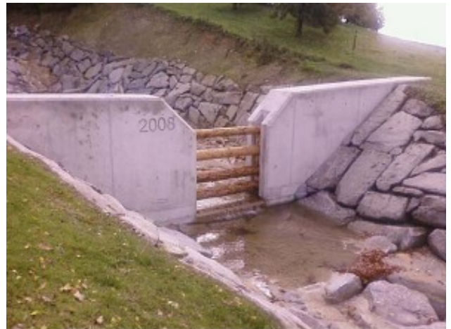
Neu fertig gestellter Geschiebesammler mit Abflussektion aus Holz.
