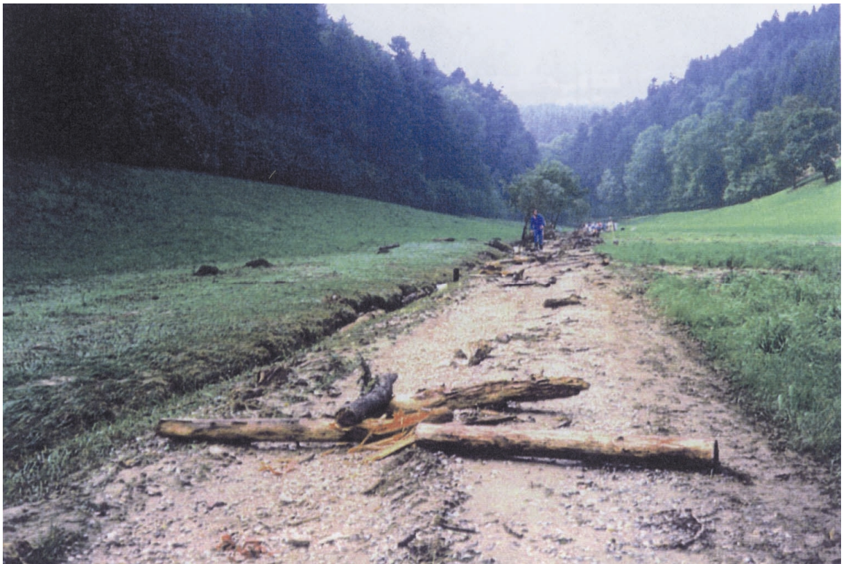
Abb. 4.3: Spuren des Hochwassers vom 16.6.1988 wenige Meter oberhalb des Einlaufes des Ruessgrabens beim Hof Oberstalden
