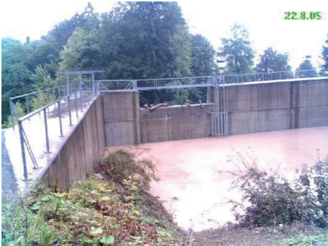
Hochwasserrückhaltebecken Steinibach nach dem Hochwasser 2005 (Bild: www.horw.ch )
