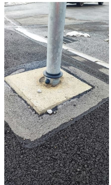
Falsche Montage überstehend
